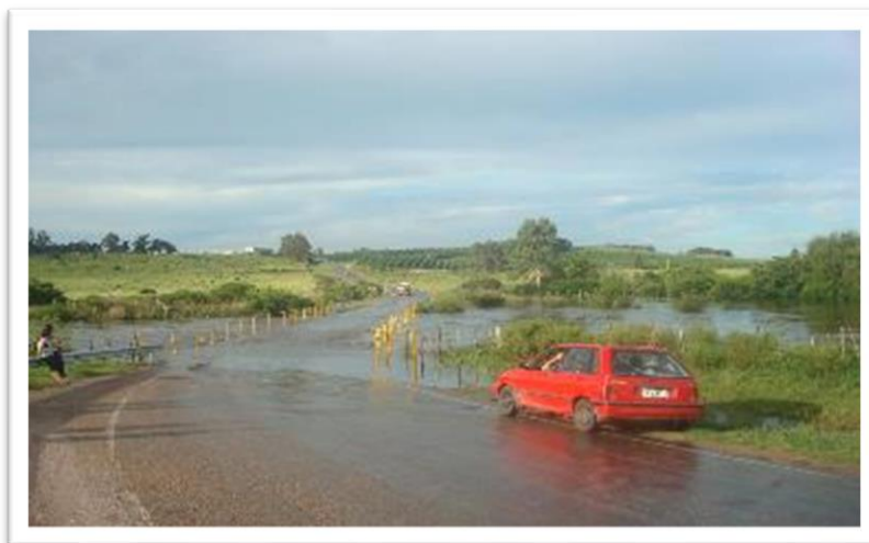
Figura 53. Puente sobre el arroyo Campanero, anegamiento
