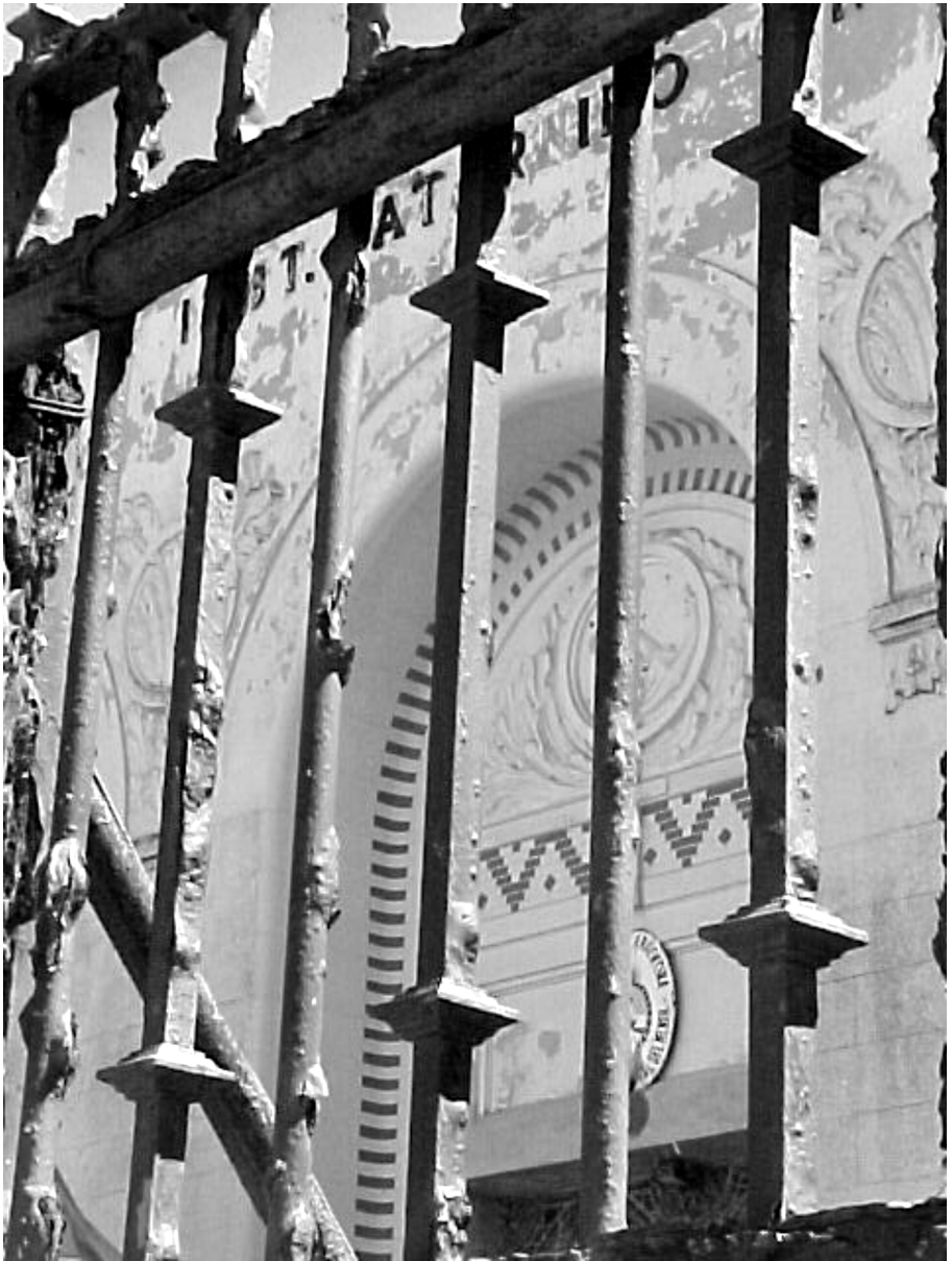
Estado de las rejas de acceso del Instituto Saturnino Unzué, previo a la restauración.
