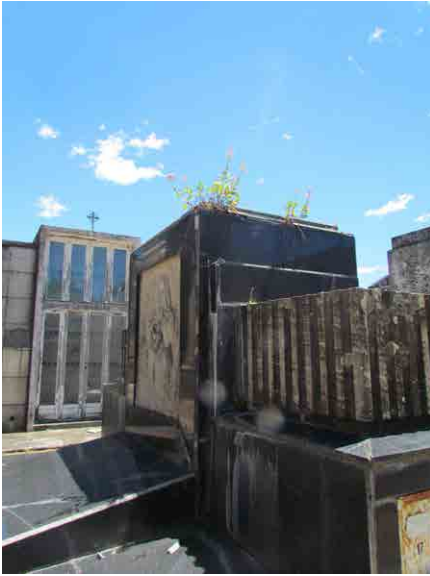
Foto1. Desprendimiento de pieza granítica
