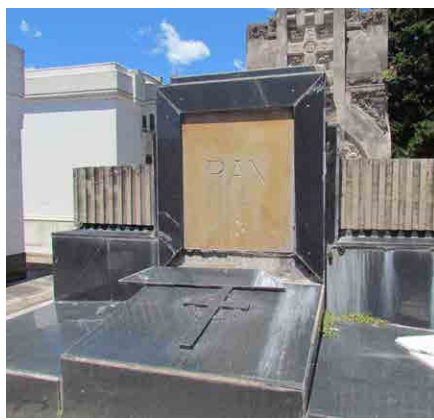
Foto 4 – manchas de sales adheridas al granito
