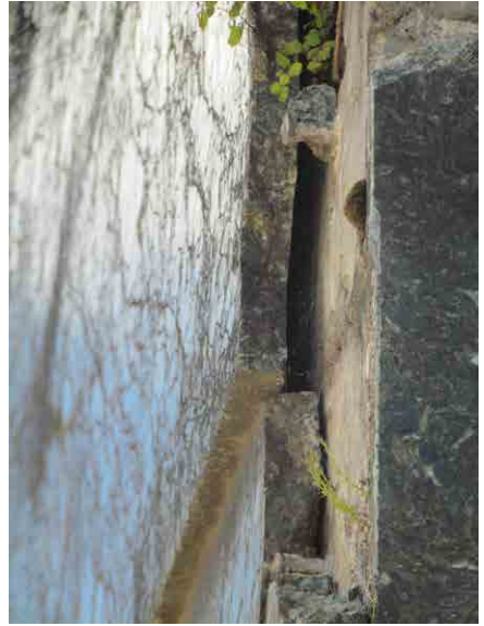
Foto 2. Caída de material - desprendimiento
