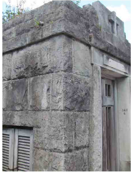
Foto 2. Musgo potenciado por salpicaduras
