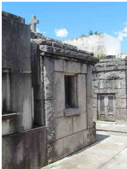
Foto 1 – suciedad en frente de piedra
