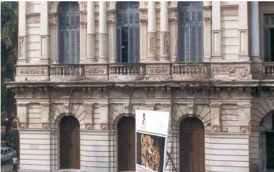
En este tramo de fachada central, nivel de balcones se detectan los mayores problemas de las fachadas relacionados con efectos de humedades, desprendimientos de tramos de revestimiento y de ornatos.
