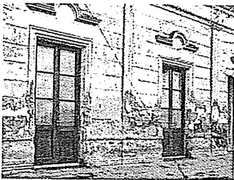
"La Rinconada de Vidal, Provincia de Buenos Aires. Imagen previa al momento de la restauración. Referencia Lámina Nº L. 3.3.
