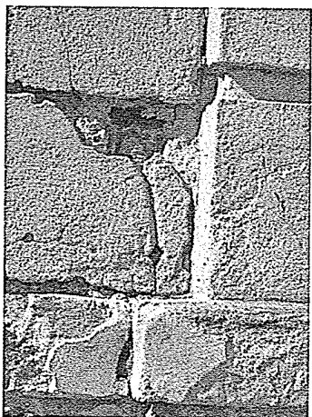
Disgregación del símil piedra posterior al craquelado no tratado.
