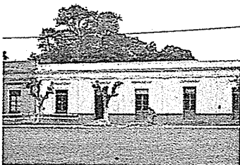
Imagen sector de la fachada general de La Rinconada en proceso de restauración.
