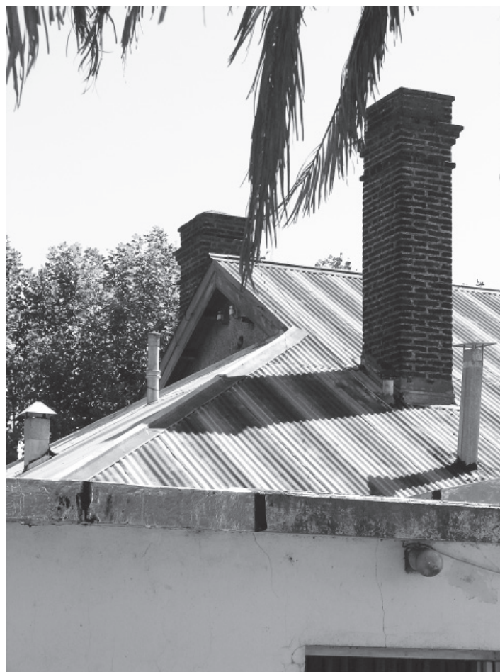
Estado actual del edificio del lavadero, sin uso ni mantenimiento, a pesar de sus valores. Fuente FRB.
