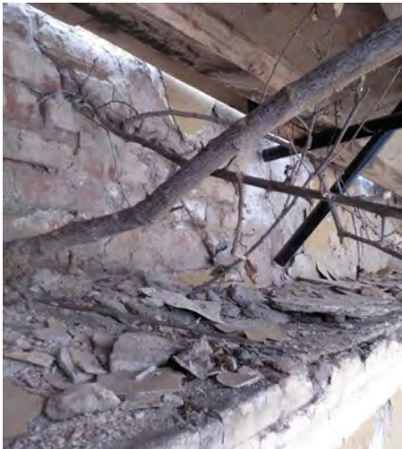
Afectación de revoques y vegetación invasiva
