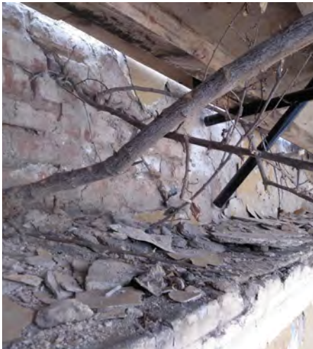
Afectación de revoques y vegetación invasiva
