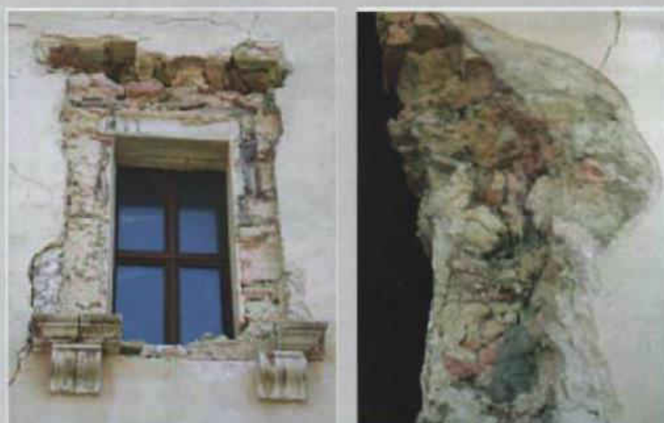
Figura 6.17 Ejemplos de inyecciones defectuosas. Se aprecian las zonas grises donde penetró la inyección en contraposición con los sectores no inyectados.
