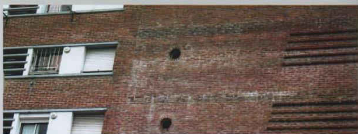
Figura 5.4 Eflorescencia sobre fachada en ladrillo visto
