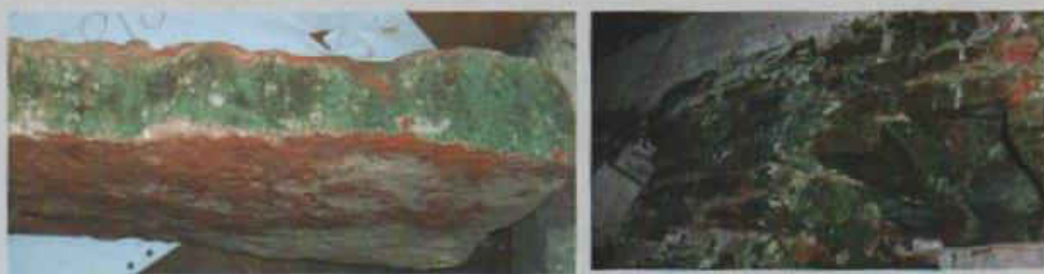
Figura 6.11 Musgo por presencia de escorrentías de agua. Atarazana de Montevideo.
