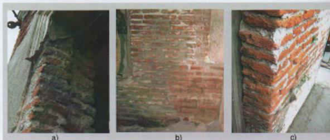
Figura 3.13 Muro de carga de fachada Vivienda en Perez Castellano 1301: a) Jamba fachada P. Alta, b) Paramento interior fachada P. Baja, c) Paramento exterior P. Alta
