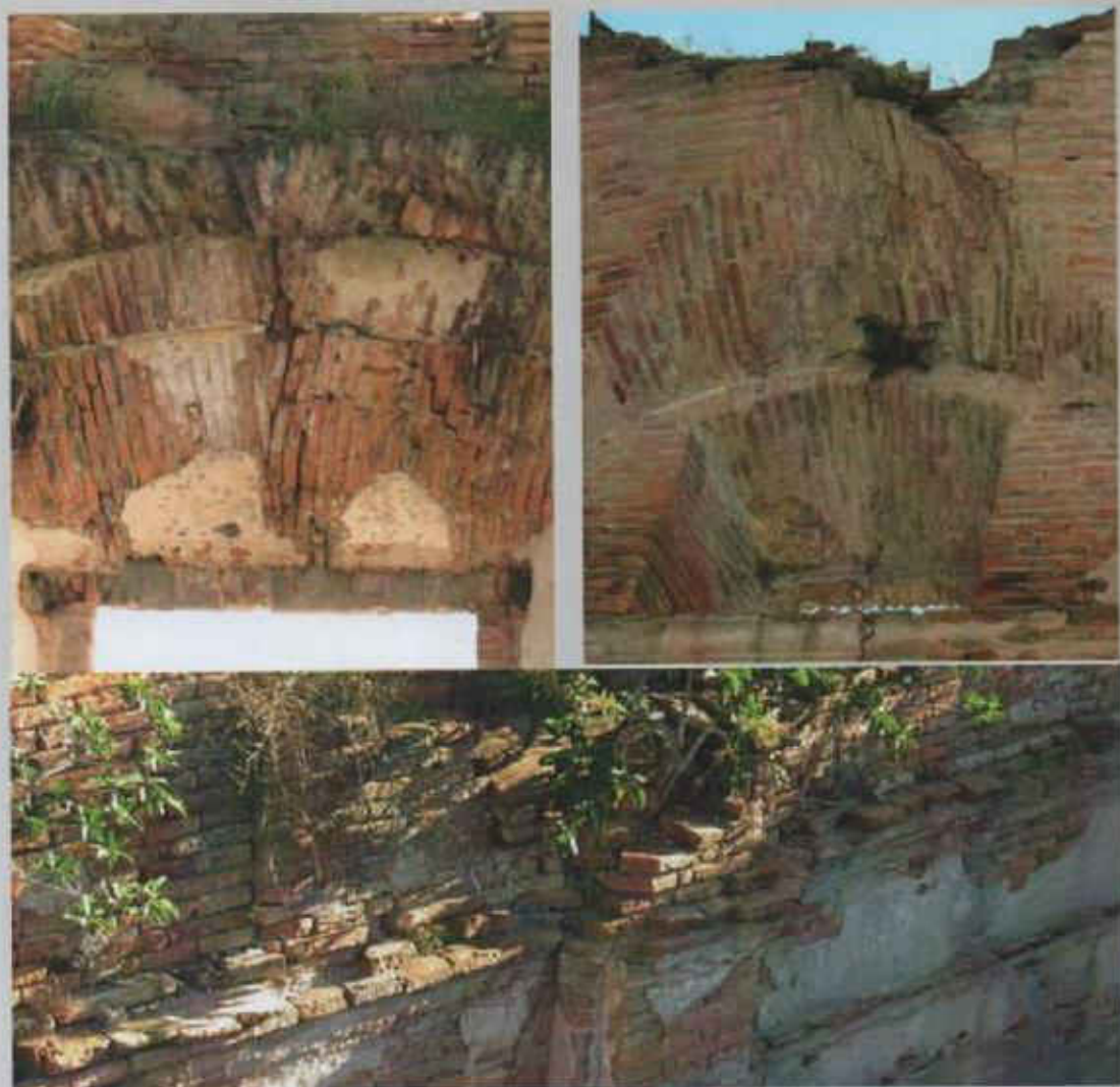
Figura 5.9 Descuelgue, grietas y desprendimientos: a) Descuelgue de dovelas dintel acceso, b) Grieta dintel acceso coro, c) Desprendimientos y roturas de saliente en cornisa interior. Capilla Calera de las Huérfanas. Carmelo, Colonia.
