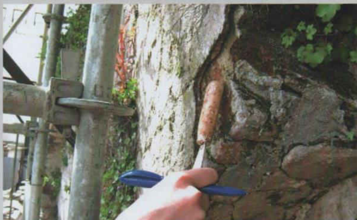
Figura 5.6 Rotura y pérdida de partes, dintel horizontal y en arco. Atarazana de Montevideo. Fuente: Asesoramiento "Consolidación Atarazana", Convenio Banco República del Uruguay- Facultad de Arquitectura. 2010
