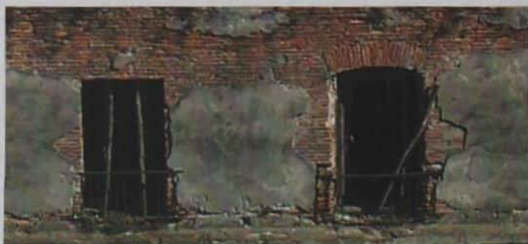
Figura 3.16 Secuencia de dinteles de vanos en Atarazana de Montevideo: dintel horizontal con jambas perpendiculares al plano de fachada y dintel en arco y jambas abocinadas.
