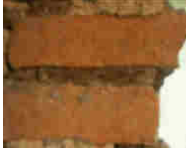
Imag. 14. Muro transversal de 0, 20 m construido en las primeras décadas del siglo XX donde se verifica el espesor de la junta que alcanza los 4 cm.
