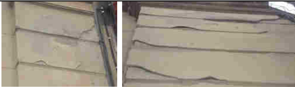
Imag. 17. Los daños actuales en la superficie permiten visualizar espesor, consistencia y acabado del revestimiento símil piedras respecto del revoque grueso Alberdi 136
