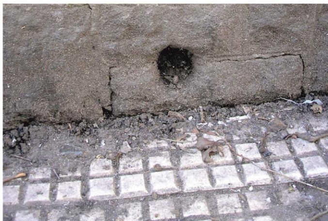
Roturas y faltantes en caños de bajada pluvial Obstrucción de conductales
