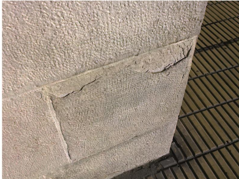
DESPLACADO en pilar de recova, edificio calle Buenos Aires 1600
