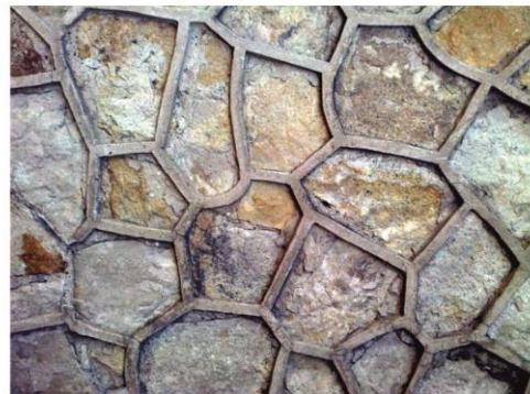
Detalle del basamento de la Capilla Stella Maris mampostería rústica con juntas en sobrerrelieve
