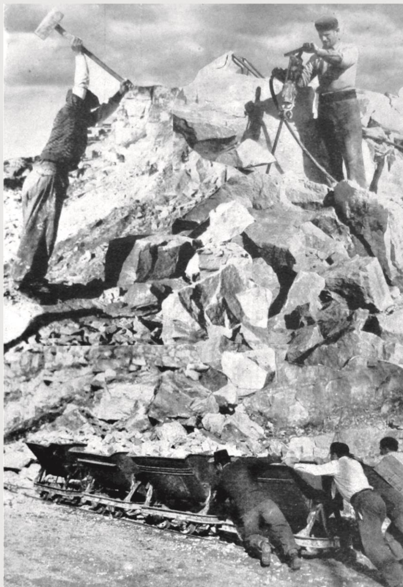
Trabajo en las canteras del Puerto de Mar del Plata. Ruptura de la roca, trabajo que se efectúa con barrenos accionados a aire comprimido, lo que permite dar gran impulso a los trabajos.
