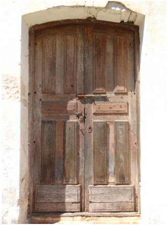
Puerta principal original con desajustes y nulo mantenimiento
