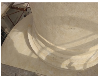
Veladura realizada como cambio en lo estipulado originalmente en el proyecto. Foto A. Yonson.
