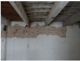
Sondeos hechos para determinar altura original de cubiertas laterales. Fotos A. Yonson.
