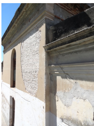
Presencia de humedades provocan desprendimientos de revoques. Fisuras en mampostería y parches de cemento. Fotos A. Yonson
