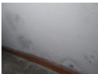
En reducidos lugares se ven signos de descascaramiento de la pintura a la cal y manchas amarillentas en revoques. Fotos A. Yonson
