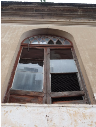
Ventana sobre puerta principal con importante grado de deterioro.
