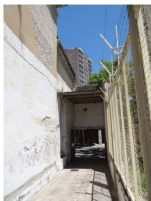
Mampostería y cubierta precaria de chapa sobre ingreso, adosados a la capilla. Fotos A. Yonson
