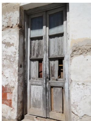
Puerta sala este en muy mal estado de conservación. Desajustes y faltantes de piezas.
