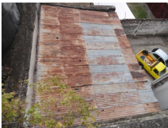
Cubiertas no originales. Gran porcentaje de chapas oxidadas. Fotos A. Yonson
