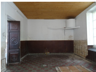
Sala oeste. El cielorraso de madera, el tanque de agua, el zócalo simil madera, son elementos no originales incorporados en el siglo XX. Es el espacio mejor mantenido. Fotos A. Yonson
