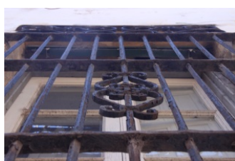
Rejas de hierro forjado con descascaramiento y oxidación.
