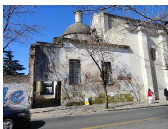
Pinturas y grafitis afectan las fachadas. Pérdida de tramos de cornisamiento original. Fotos A. Yonson
